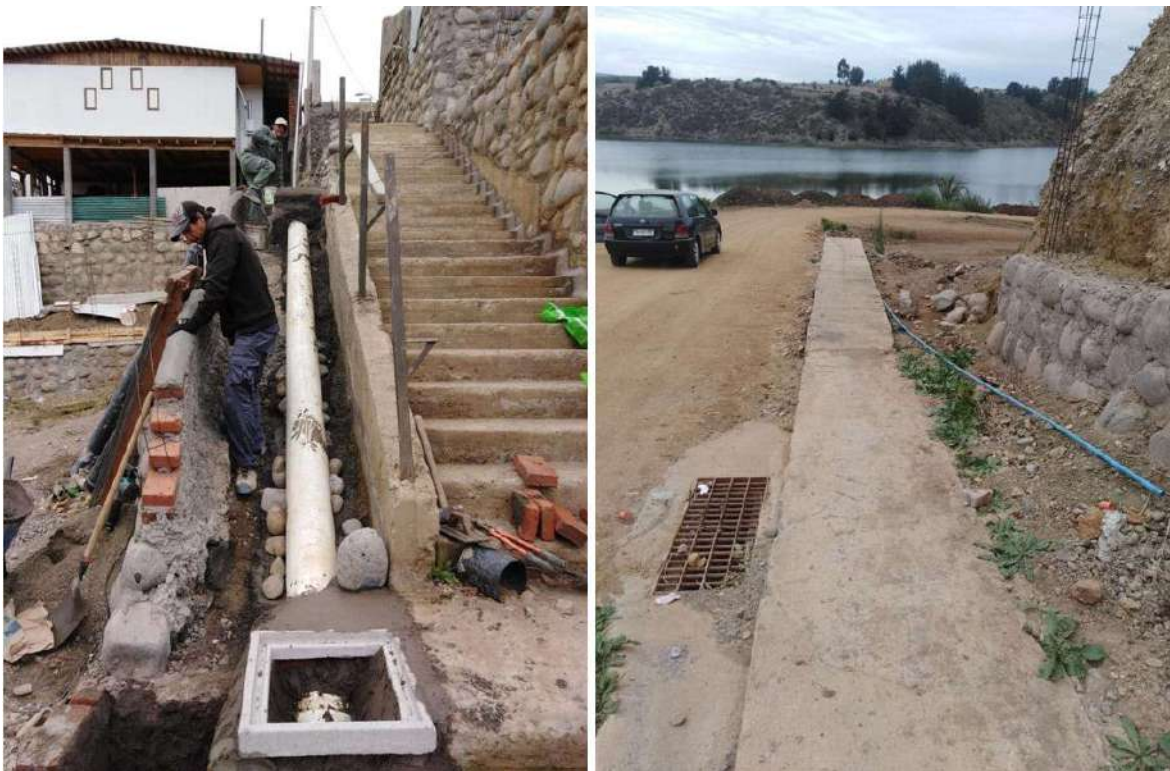
Figura 15: Sistema de drenaje de aguas lluvias (alcantarillas).
