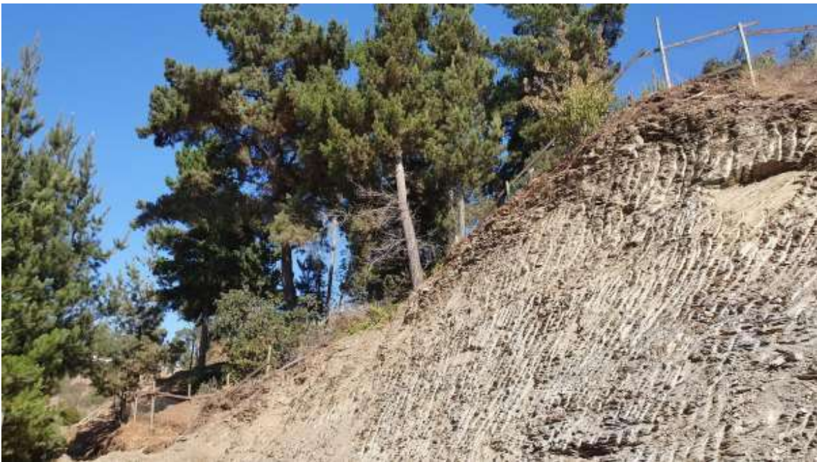
Figura 14: Ladera al sur del terreno, se observa grado de reptación de suelo indicado por postura de árboles.
